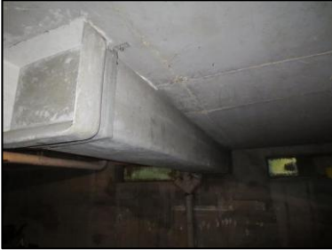
Photo N° 880 AMIANTE CIMENT -- DEGAGEMENT -1 Gaines & coffres horizontaux Ventilation haute (Fibres-ciment)
